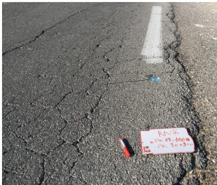
Figure 1. Exemple de dégradations sur la RN 56.
