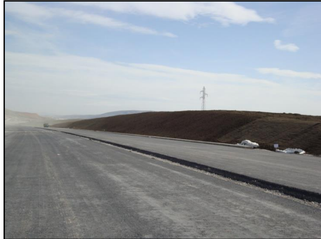
Figure 1. Talus marneux à traiter.
