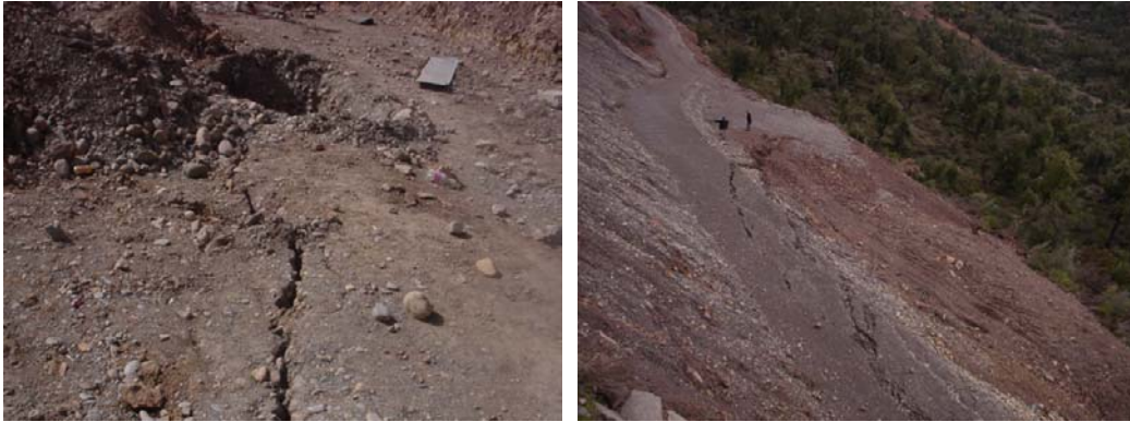
Photos 4 et 5 : Fissures longitudinales
