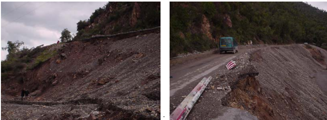
Photos 1 et 2 : vue du glissement
